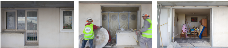
Abb. 52: Baumaßnahmen für die Öffnung der Schiebefenster in bewohntem Zustand (o.J.) Bild/Quelle: Philippe Ruault / Dana 2016: 44
