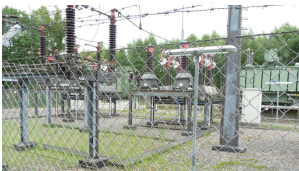
Abbildung 72: Umspannwerk am Gleisbaubetrieb Quelle: Eigenes Foto
