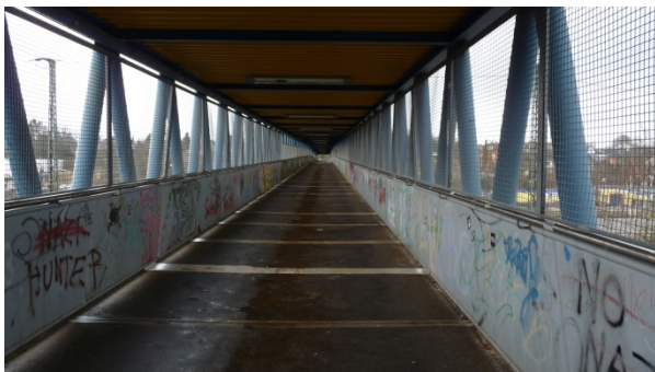
Abbildung 24: Beengende und erneuerungsbedürftige Tigerbrücke Quelle: Eigenes Foto
