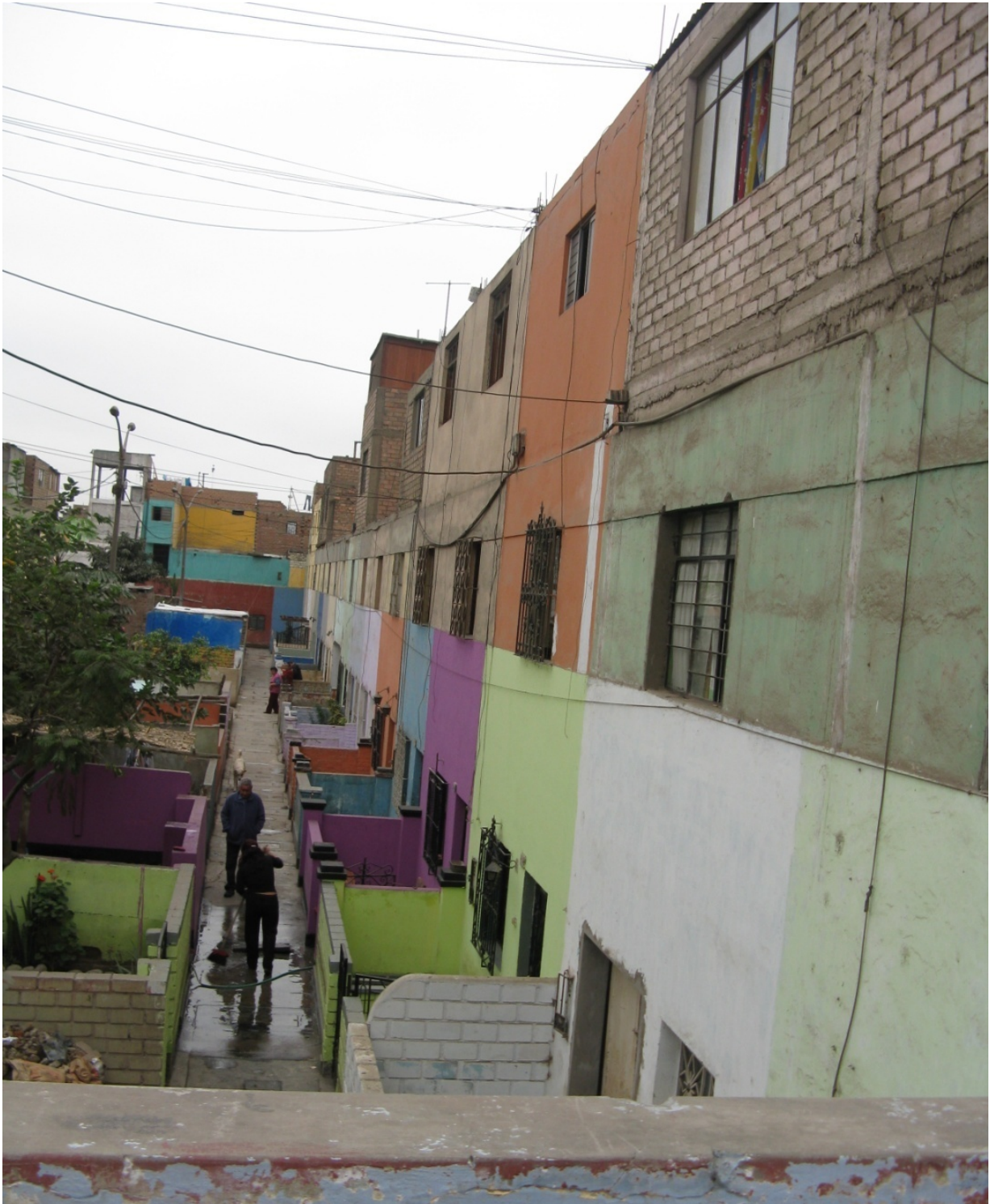
[56] Typ A: Erweiterung bestehender Wohneinheiten durch Dachaufbauten in einer zweigeschossigen Blockbebauung (Barrio Obrero N°4) Foto: P.C.T. 2011
