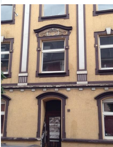
Abbildung 25: Altbau mit Defiziten in Hochfeld
