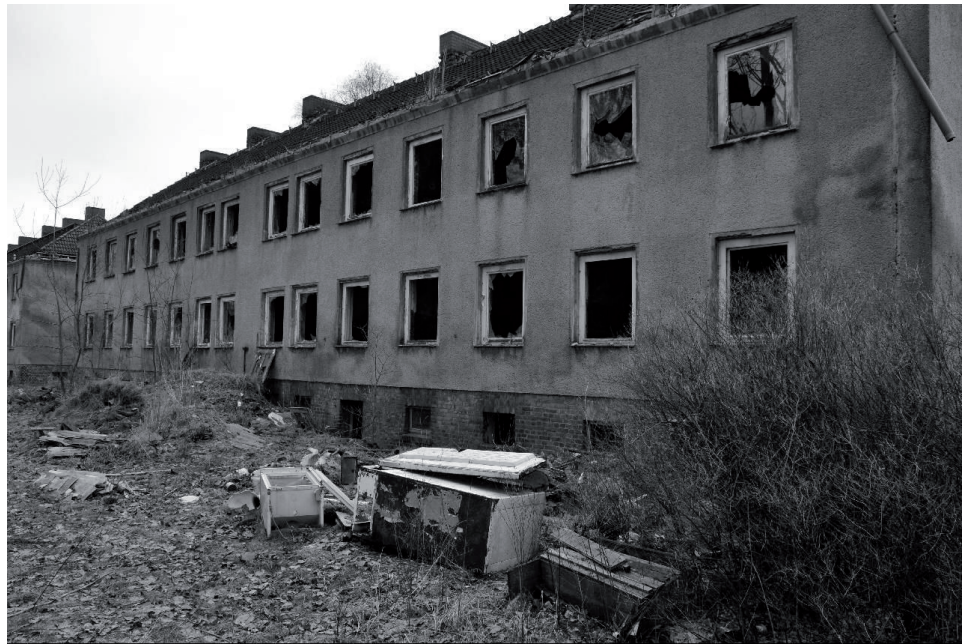
Abb. 9: Vandalismus und Defizite im öffentlichen Raum, verursacht durch Leerstand
