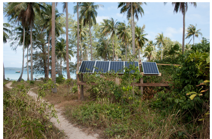
Abb. 22 PV-Anlage (Bild 2) Versorgt derzeit Beleuchtung und Ladestation für Haupthaus, Dorm
