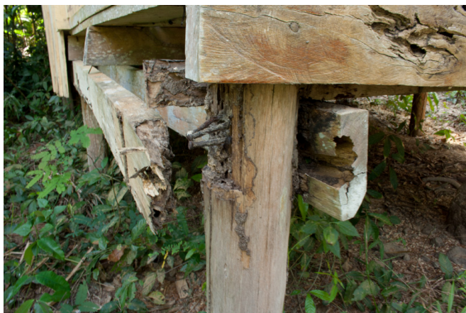
Abb. 52 Schaden am Bungalow durch Termitenbefall
